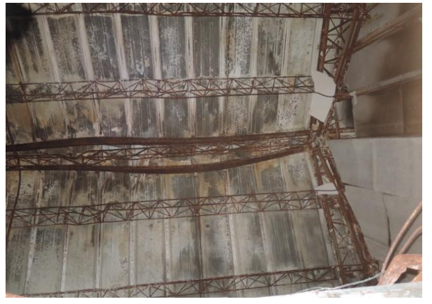
修復前鋼架情形(火燒過)
