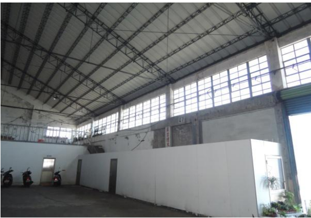
修復前鋼架及搖擺窗情形
