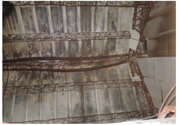
修復前鋼架情形(火燒過)
