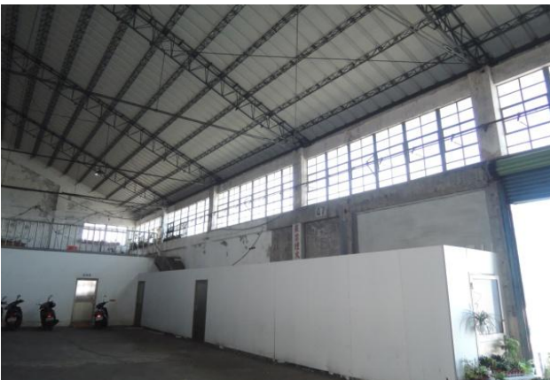
修復前鋼架及搖擺窗情形
